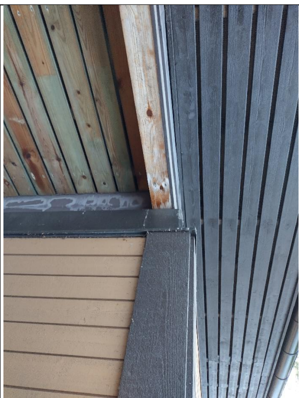
Kuva 11. Syvennyksen kohdalla havaittiin vanhoja kattovuotoja.
