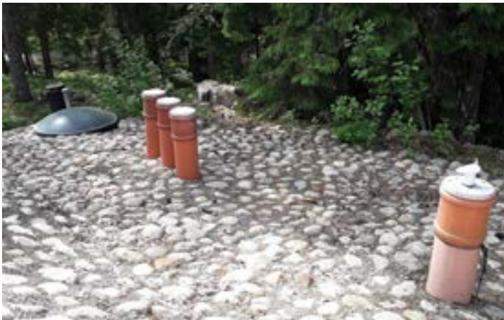
Jätevesijärjestelmistä näkyy yleensä vain maanpäälliset putket ja kaivonkannet. Maan alla piilossa ovat, tyhjennystä aina väljään tarvitsevat saostussäiliöt tai -kaivot, umpisäiliöt ja laitepuhdistamot. (Kuvat: Länsi-Uudenmaan vesi ja ympäristö, LUVY)
