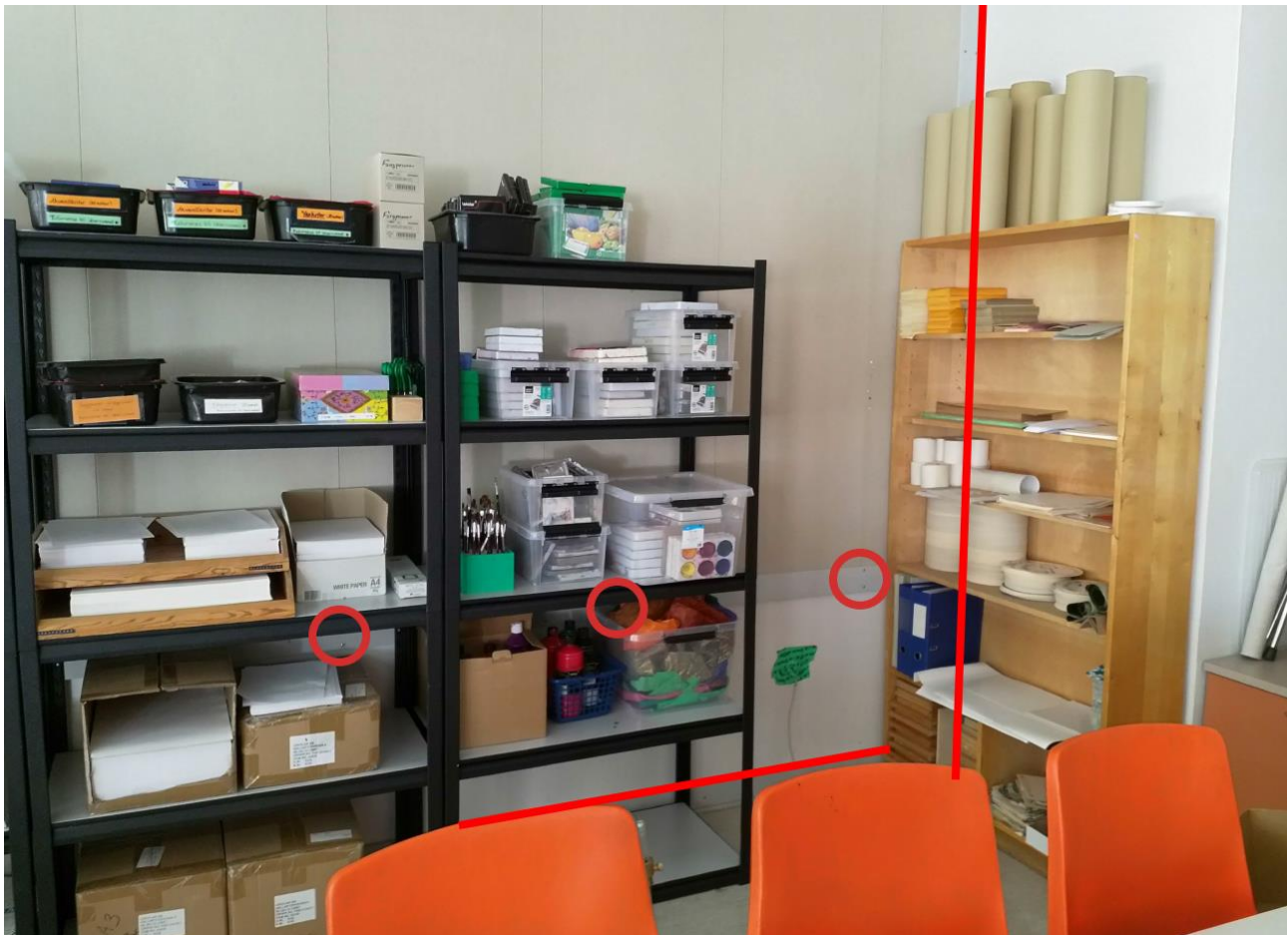
Kuva 5. 2.kerroksen merkkiainekoe MAK4. Vuotopaikat on merkitty kuvaan punaisella.
