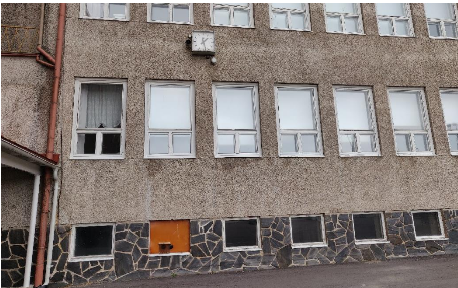
Kuva 12. Syöksytörvien liitosten vuodot ovat kastelleet ulkoseinärakennetta itäsiivessä.
