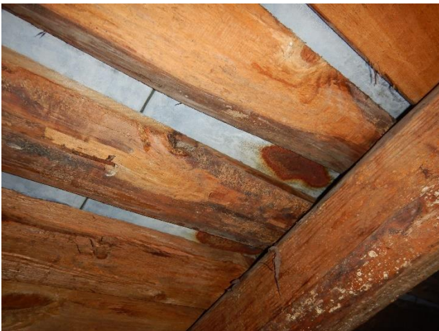
Kuva 14. Vesikatteen ruosteaurio ja kuva alakattotilasta.
