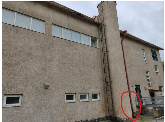
Kuva 29. Pohjoissivun vauriokohta sijaitsee syöksytornin kohdalla.
