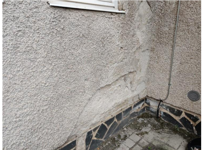
Kuva 27. Rappauksen kunto pääoven vieressä.
