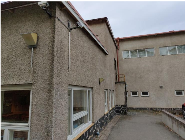
Kuva 28. Vaurioitunut varaston seinä.
