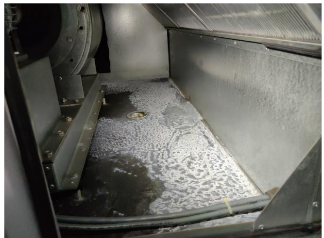
Kuva 52. Kammion pohjat on viemäroity.
