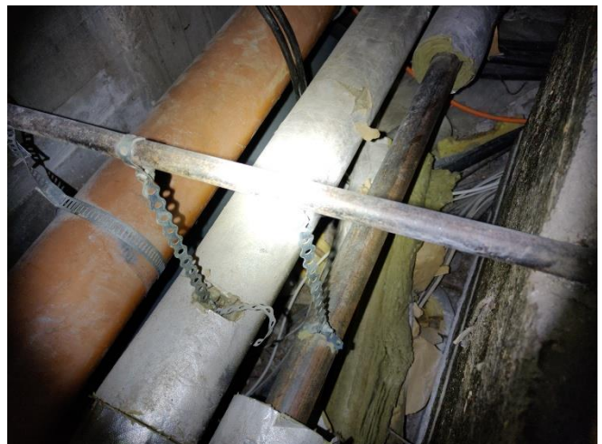
Kuva 28. Itäsiiven ja keskiosan välissä kulkeva putkikanaali.
