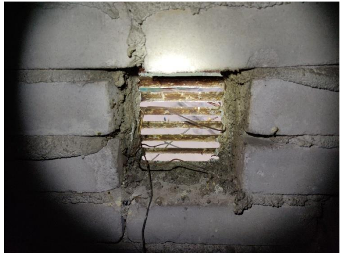
Kuva 55. Tuuletusaukoista puuttuu jrsijäverkot.
