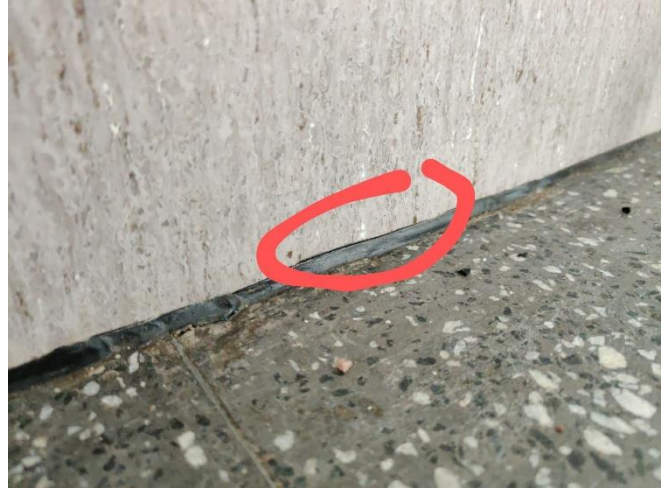
Kuva 24. MAK1 vuotoa (AP3, käytävä).
