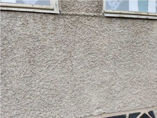
Kuva 38. Itäsiiven ikkunan alanurkasta lähtevä halkeama.
