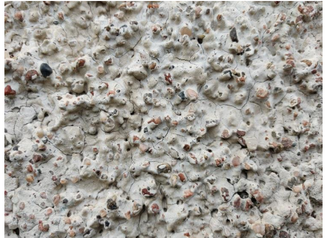
Kuva 39. Pienempää verkkoimaista halkeilua itäsiivessä.
