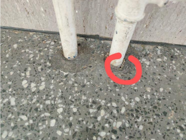
Kuva 23. MAK1 vuotoa (AP3, käytävä).
