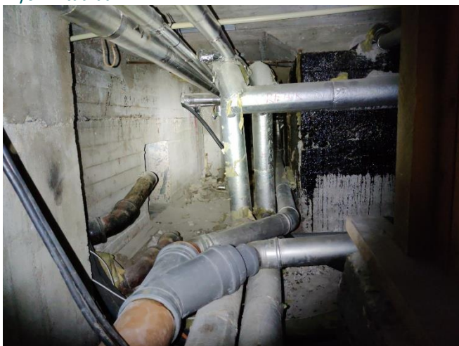
Kuva 27. Itäsiiven ja keskiosan välissä kulkeva putkikanaali.
