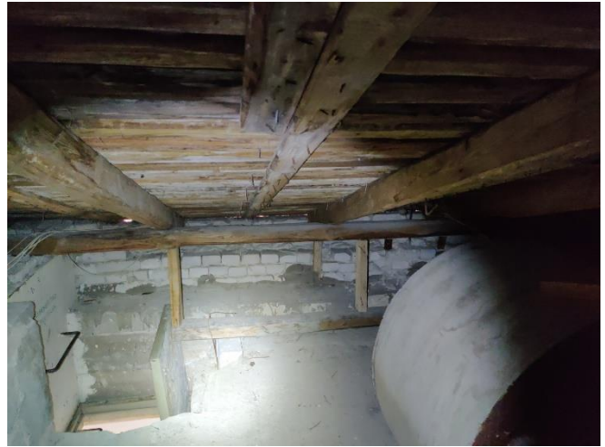
Kuva 53. Sivuräystäiden kautta tapahtuva tuuletus on tukittu.
