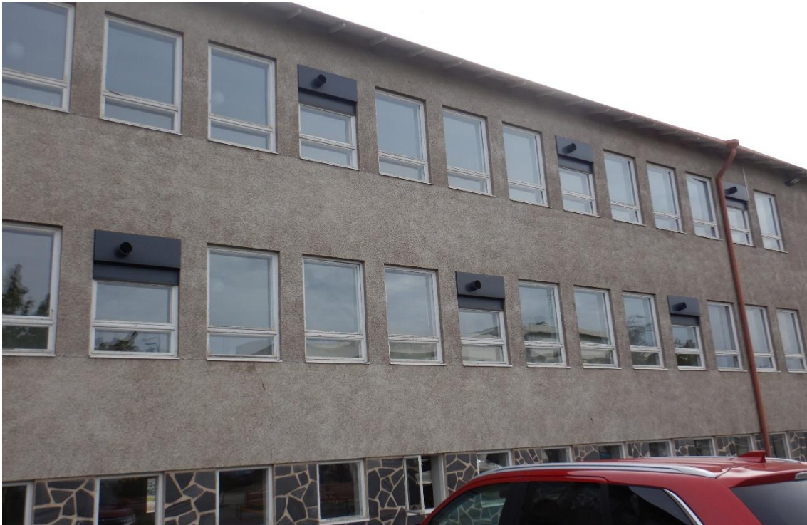
Kuva 6. Kohteen luokkatilojen ilmanvaihto on toteutettua usealla luokkakohtaisella koneella, joiden ulkoilmanotto sijaitsee remontoitavan rakennusosan yläpuolella.
