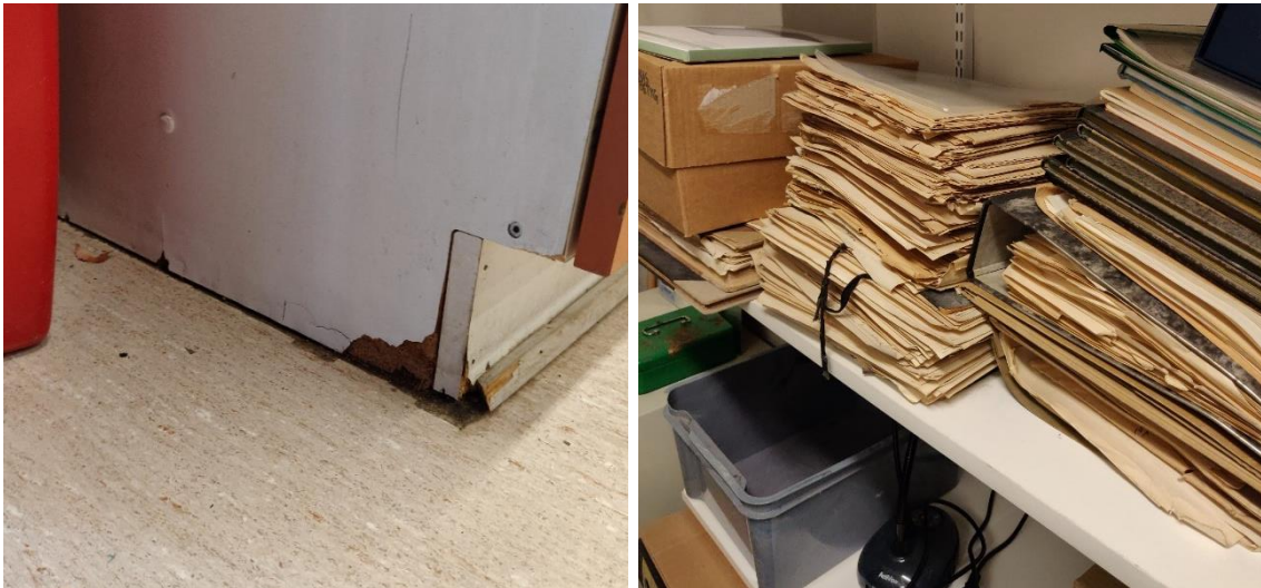
Kuva 5. Luokkatilan 6 kalusteissa on vesivauriojälkiä. Rehtorin kanslian viereisessä varastossa on paljon vanhoja tunkkaisia papereita.
