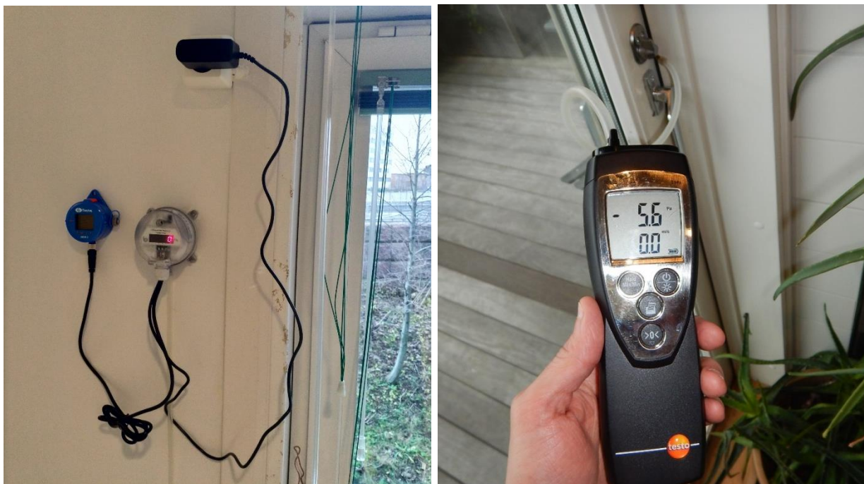
Esimerkkikuva. Jatkuvatoiminen (loggaava) paine-eromittaus (vasen kuva). Hetkellinen paine-eromittaus (oikea kuva).
