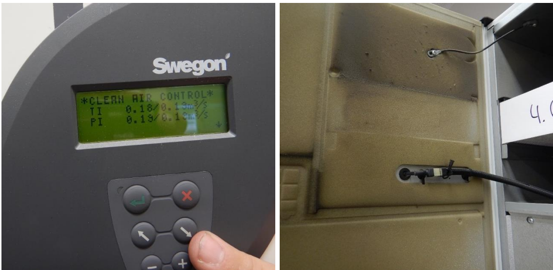
Kuva 7. Kohteen koneissa oli käytössä Clean Air Control -toiminto, mutta tulo- ja poistoilmavirrrat olivat säädetty manuaalisesti lähes maksimi-ilmavirroille. Koneen seinässä oleva äänenvaimennusmateriaali toimii myös tiivisteenä. Pinnat todettiin ehjiksi ja tiiviiksi, eikä ohivuotoa tai sekoittumista merkittävässä määrin tapahdu.
