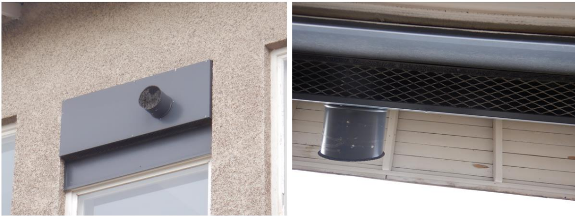
Kuva 9. Yksi kohteen Swegon TBHE -ulkoilmayksikköjen jäteilmakanavanritilöistä selvästi tukkeutunut. Jäteilmakanava sijaitsee myös muista ulkoilmayksiköistä poiketen oikealla puolella (vrt. Kuva 6).
