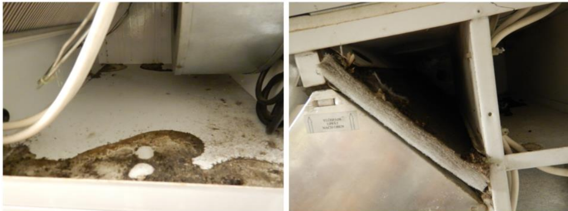
Kuva 13. Koneen sisätilat ja tuloilmasuodatin todettiin tutkimuksissa pahoin likaantuneiksi.
