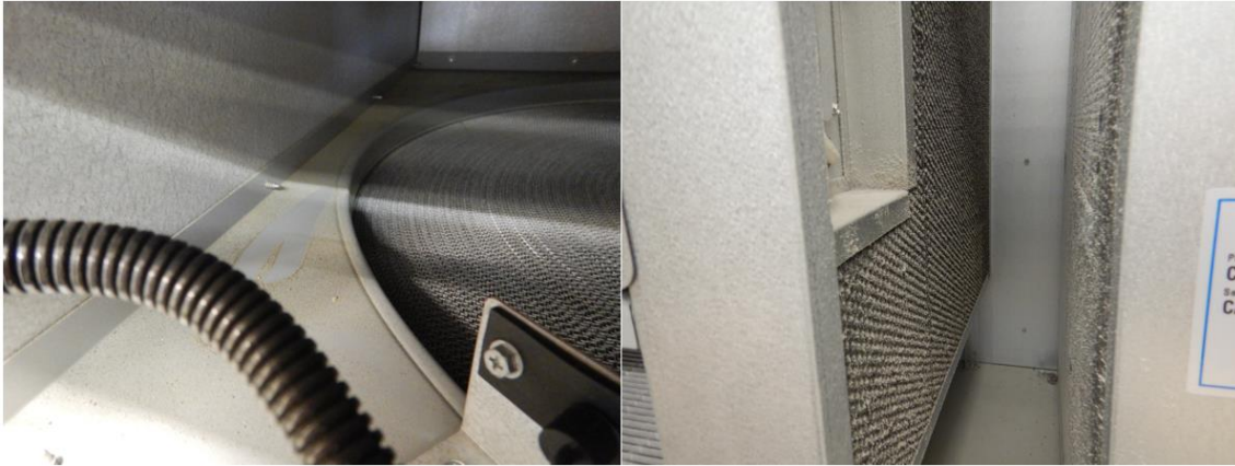
Kuva 8. Koneen pinnat havaittiin silmämääräisesti likaantuneiksi, niin tulo- kuin poistoilmapuolilla.
