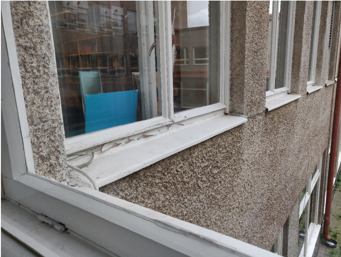
Kuva 2. Käytävien ikkunoiden kunto on huono. Pellitysten kaato on puutteellinen.
