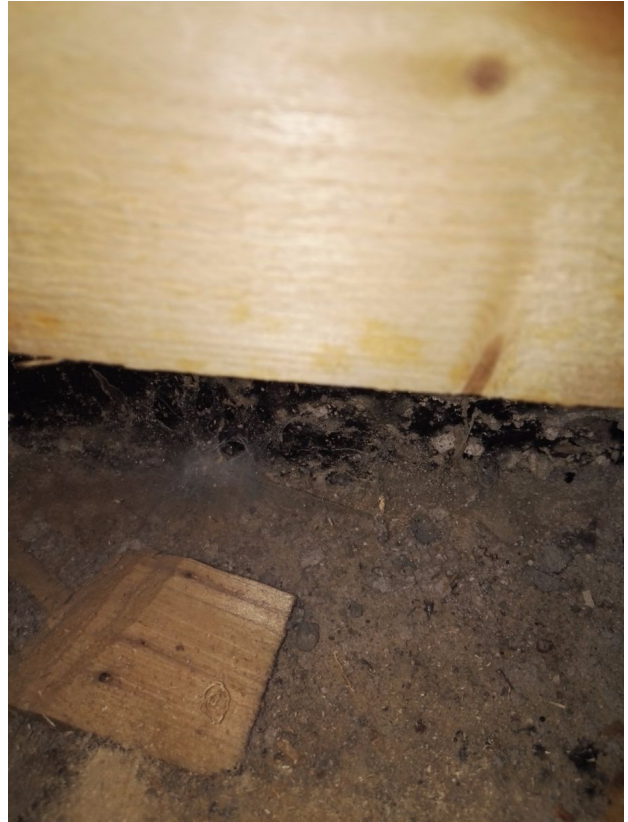
Teknisen työn luokka. Avauksen kohdalla rakenteessa ei ole betoni-/siporexmurskaa, kuten edellisissä avauksissa. Betonilaatassa kohonneita kosteuspitoisuuksia pintakosteudenilmaisimella tarkasteltuna. Näyte 7, puukappale. Näyte viittaa vaurioon.
