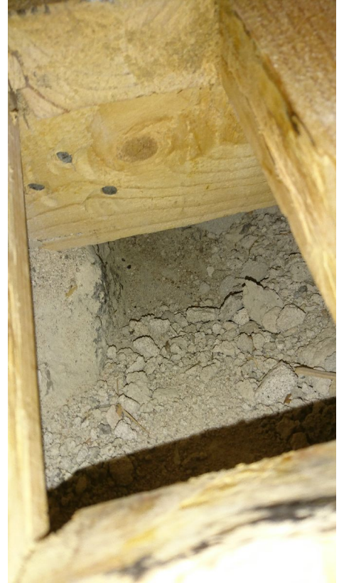
Teknisen työn luokka. Avauksen kohdalla rakenteessa betoni-/siporexmurskaa. Näyte 5, eristetäyttö. Näytteessä on vahva viite vauriosta. Näyte 6, puukoolaus. Näytteessä ei viitettä vauriosta.
