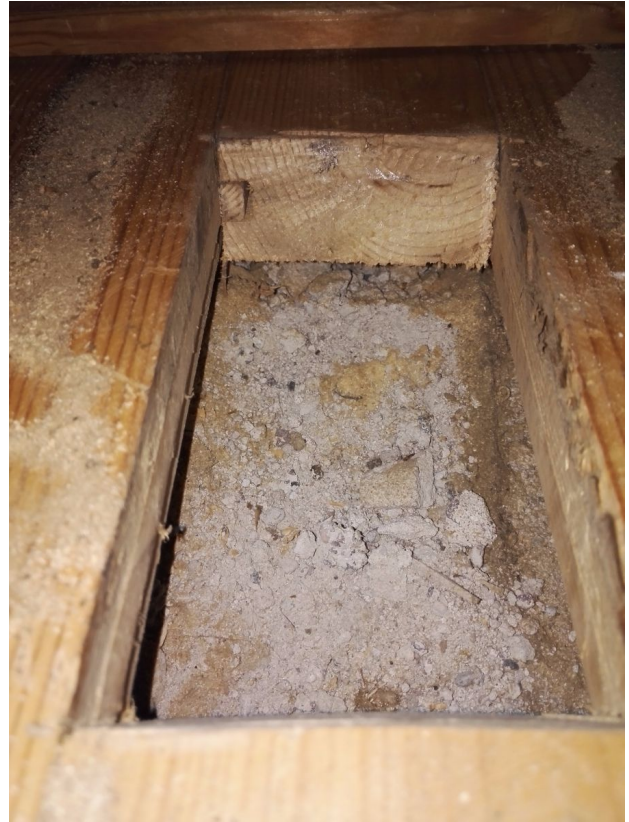
Puutyöluokka. Avauskohdassa runsaasti täyttömateriaalia. Näyte 10, eristetäyttö. Näytössä on vahva viite vauriosta. Näyte 11, puu ja pahvi. Näytteessä on heikko viite vauriosta.
