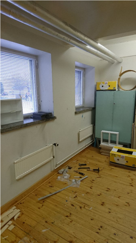
Puutyöluokan varasto. Näyte 12, lattian puukoolaus. Näytteessä on vahva viite vauriosta. Näyte 13, eristetäyttö. Näytteessä on vahva viite vauriosta. Lattiassa kosteus on lievästi kohonnut.
