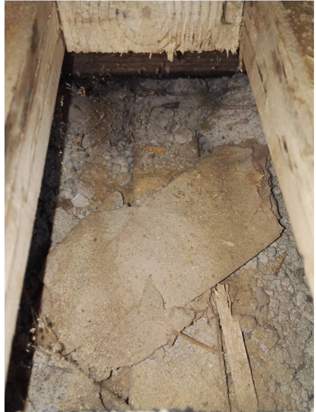
Puutyöluokka. Käytävän ja luokkatilan väliseinän alaosassa kohonneita kosteuspitoisuuksia pintakosteudenilmaisimella tarkasteltuna. Näyte 8, lattian eristetäyttö. Näytteessä on vahva viite vauriosta. Näyte 9, täytön seassa oleva puukoolaus. Näytteessä on vahva viite vauriosta.
