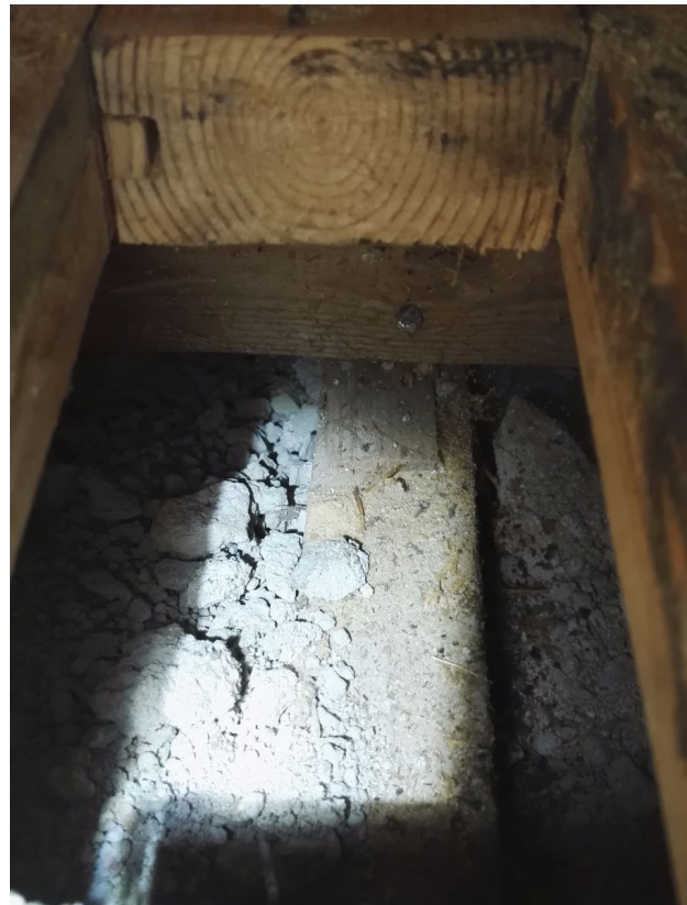
Teknisen työn luokka. Käytävän ja luokkatilan seinän alaosassa kosteus koholla pintakosteudenilmaisimella tarkasteltuna. Näyte 3, eristetäyttö. Näytteessä on vahva viite vauriosta. Näyte 4, täytön seassa oleva puukoolaus. Näyte viittaa vaurioon. Kosteusmittaus 1 tehtiin tämän avauksen täytöstä.
